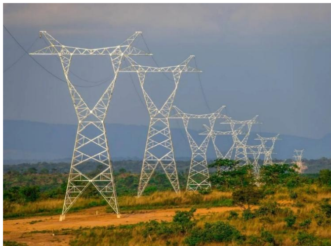
Figura 3: Linha de transmissão de alta tensão típica.
